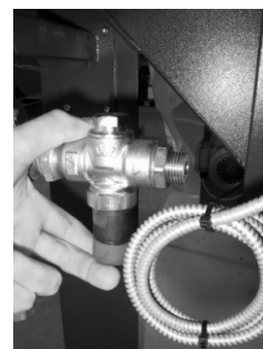
Sprinklerventil med demonterad slang
