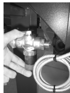
Sprinklerventil med demonterad slang
